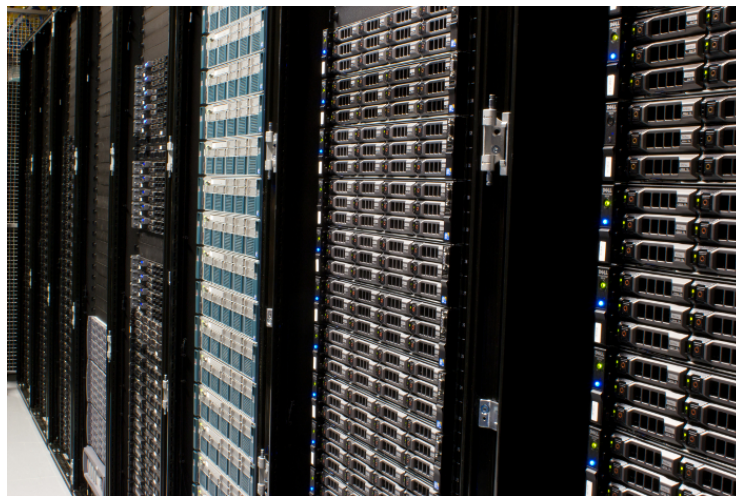
Une allée de serveurs dans un centre de données
